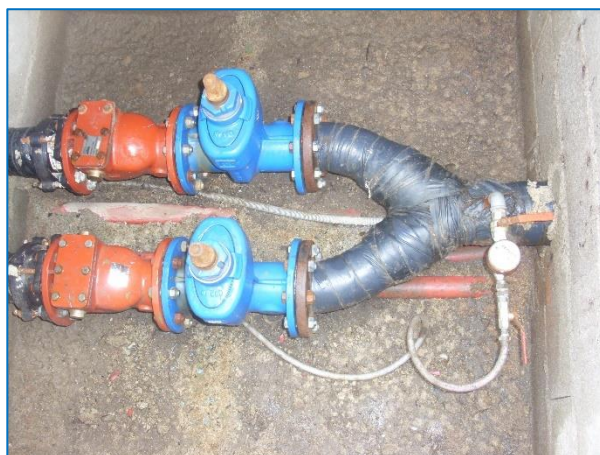
Chambre de vannes
